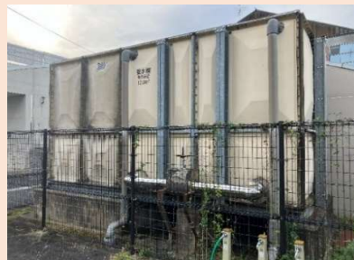
貯水槽水道の例（受水槽）
