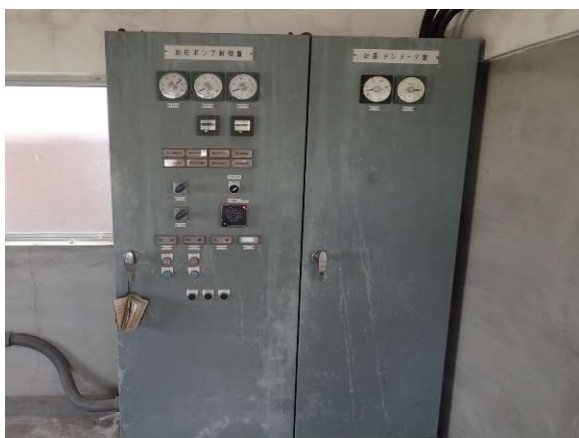
老朽化した電気設備
