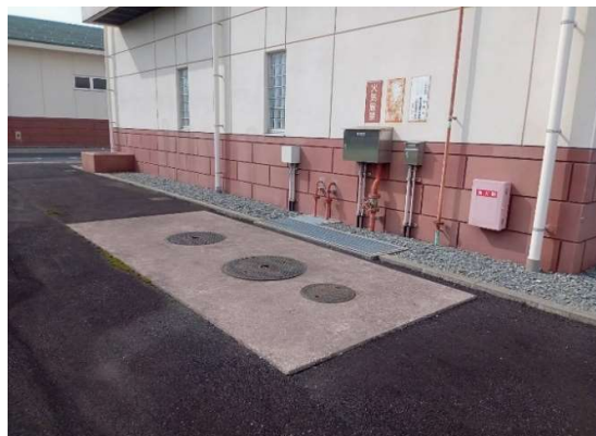
地下式備蓄燃料タンク(江山浄水場)
