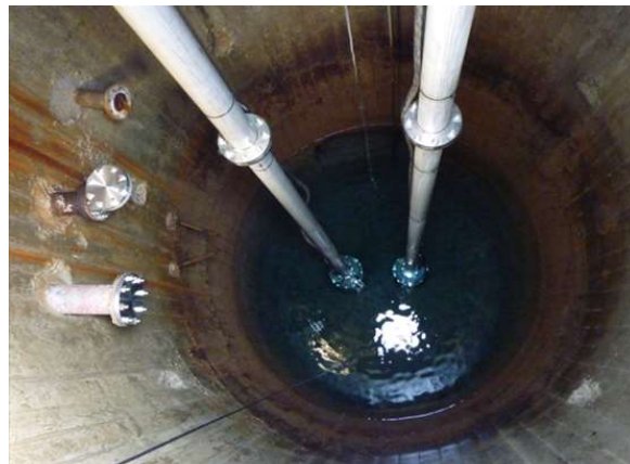
浅井戸(用瀬浄水場)
