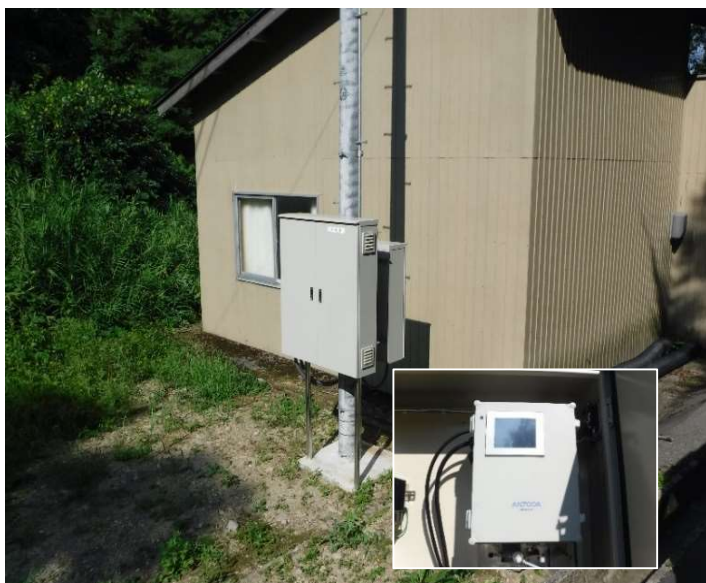
自動水質監視装置
