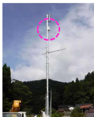
防災無線に取り付けた中継器を経由し、携帯電話の基地局へ電波を飛ばします。
