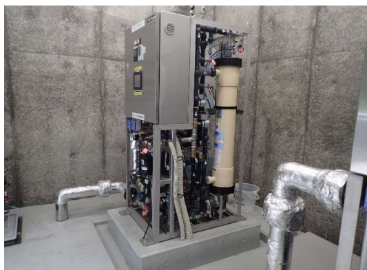
膜ろ過装置 (大石浄水場)
