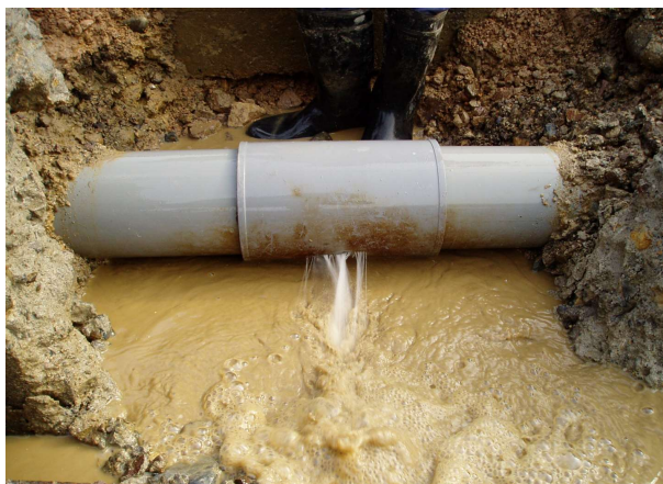
公道漏水の状況(TS継手のビニル管)
