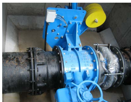
緊急遮断弁（米里配水池）
