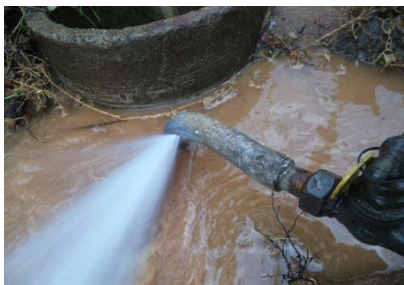
図 2.16 鉛製給水管からの漏水
