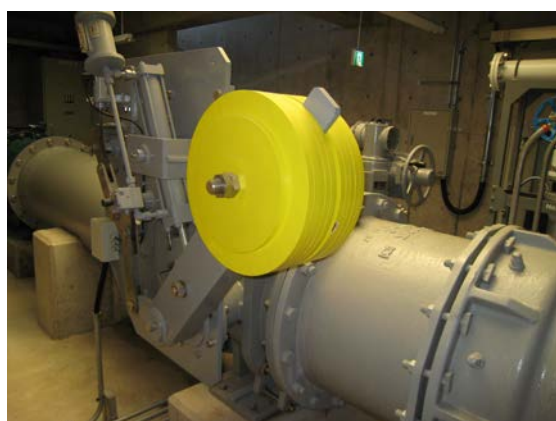
緊急遮断弁（江山浄水場浄水池）
