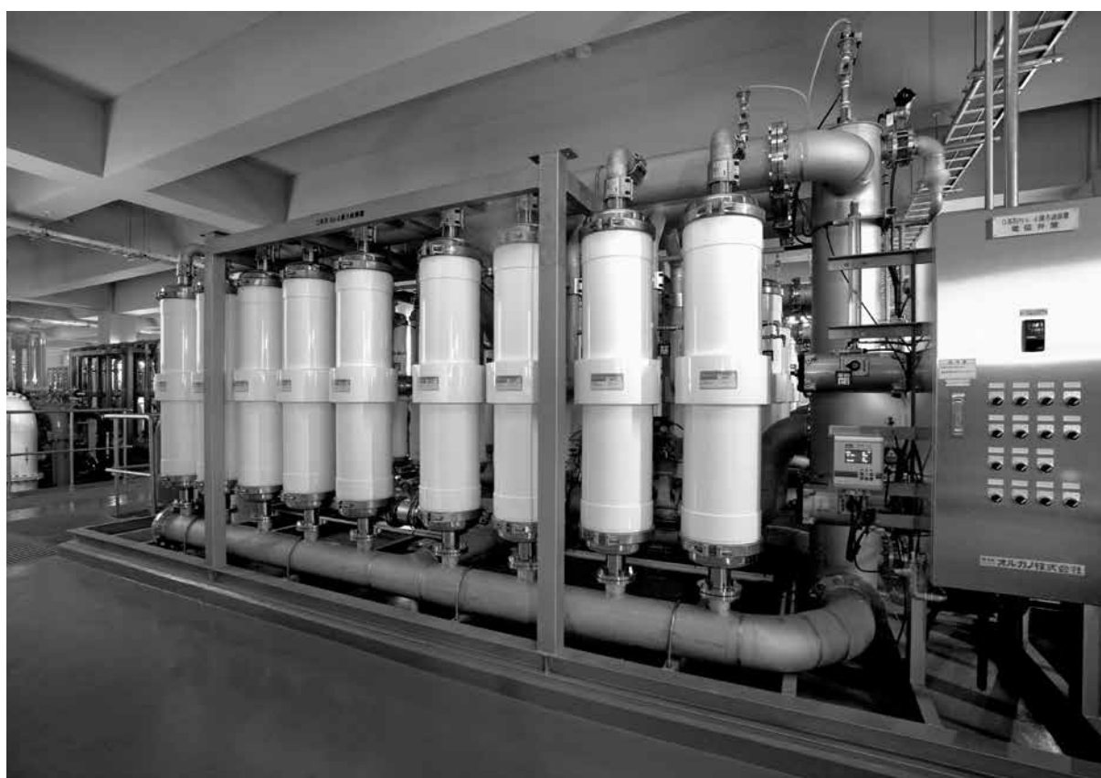
江山浄水場 膜ろ過ユニット
