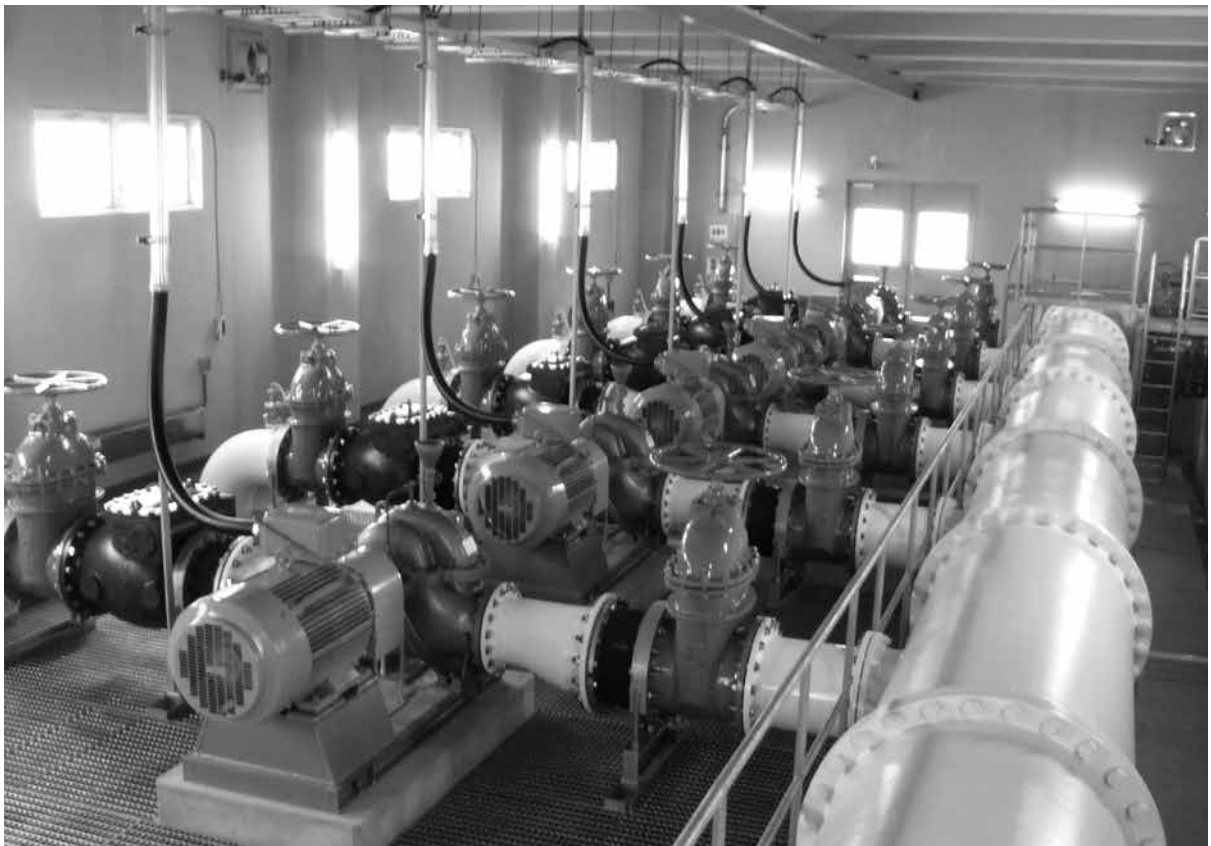
江山浄水場 原水ポンプ室
