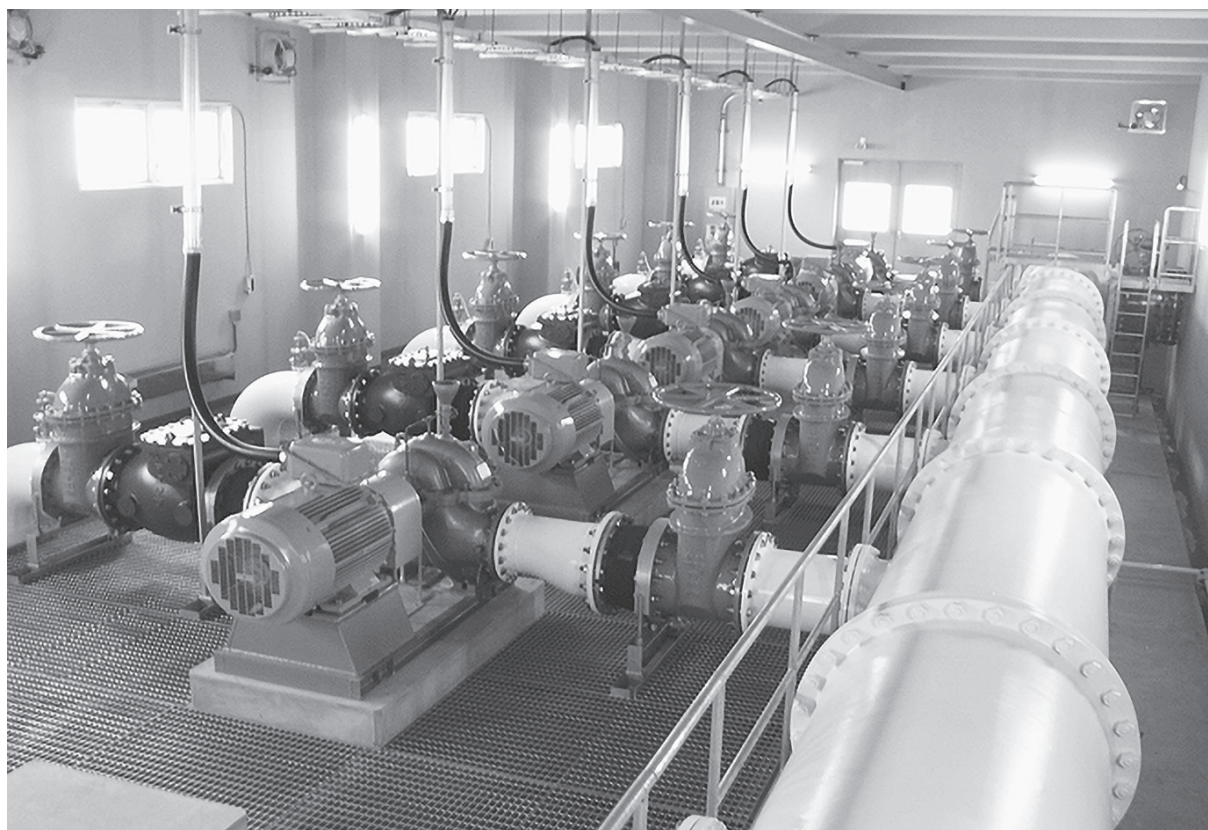
江山浄水場 原水ポンプ室
