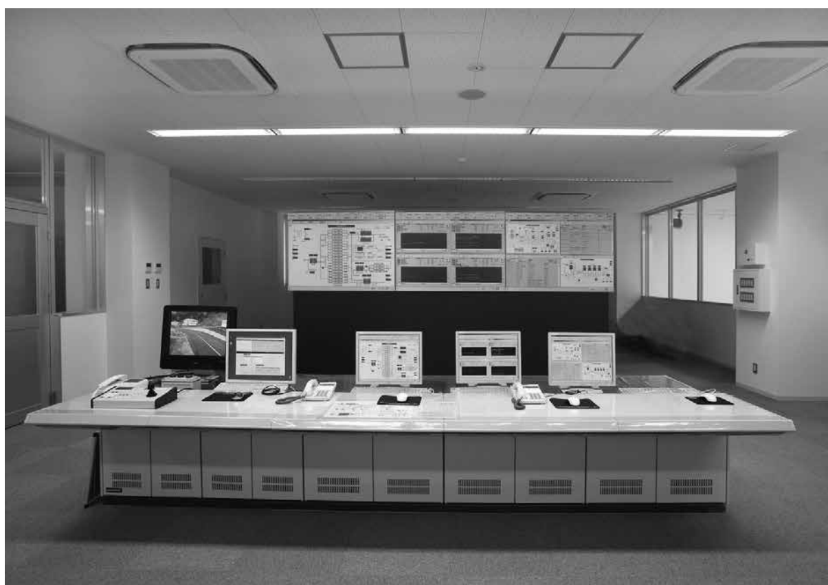
江山浄水場 中央監視室
