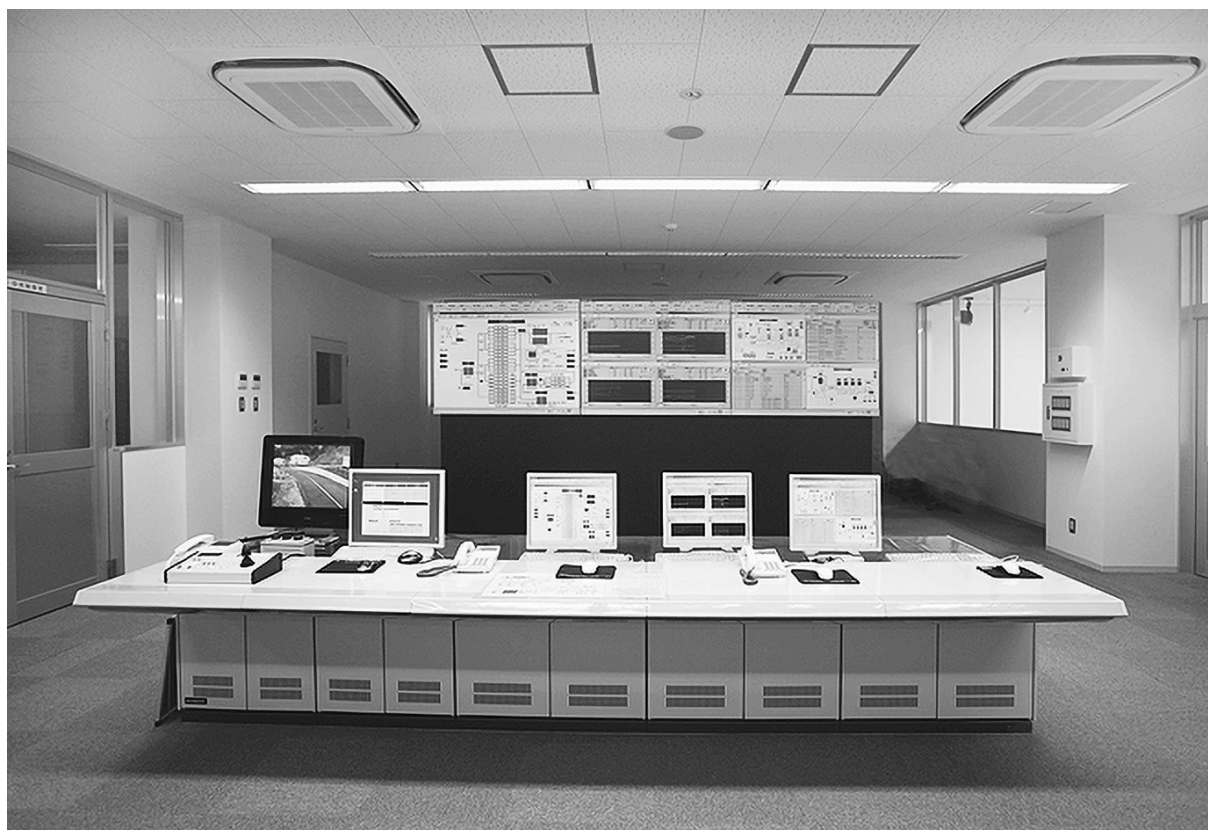
江山浄水場 中央監視室
