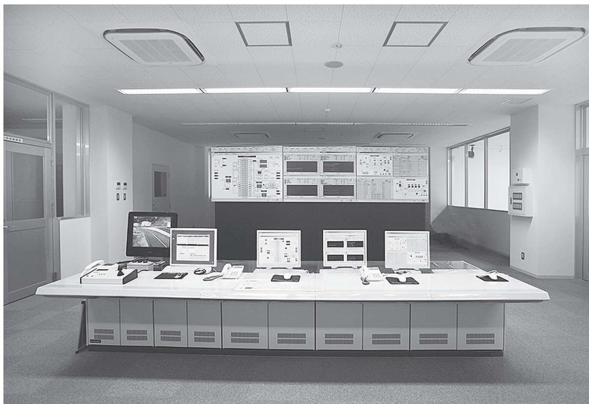
江山浄水場 中央監視室
