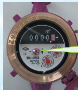
水道メーター
