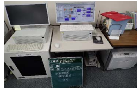
大井第二ポンプ場ほか遠方監視設備工事 (監視端末)
