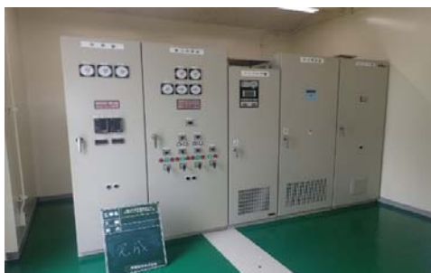
賀露ポンプ場電気設備工事 (完成)
