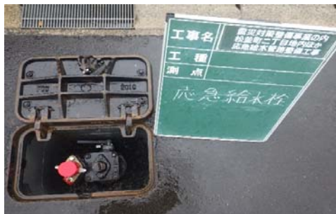
松並町二丁目地内ほか応急給水管路整備工事 (応急給水栓)
