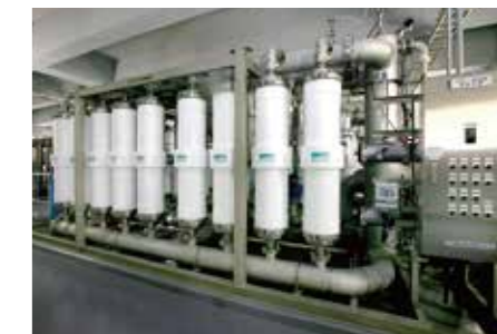
膜ろ過ユニット(江山浄水場)
