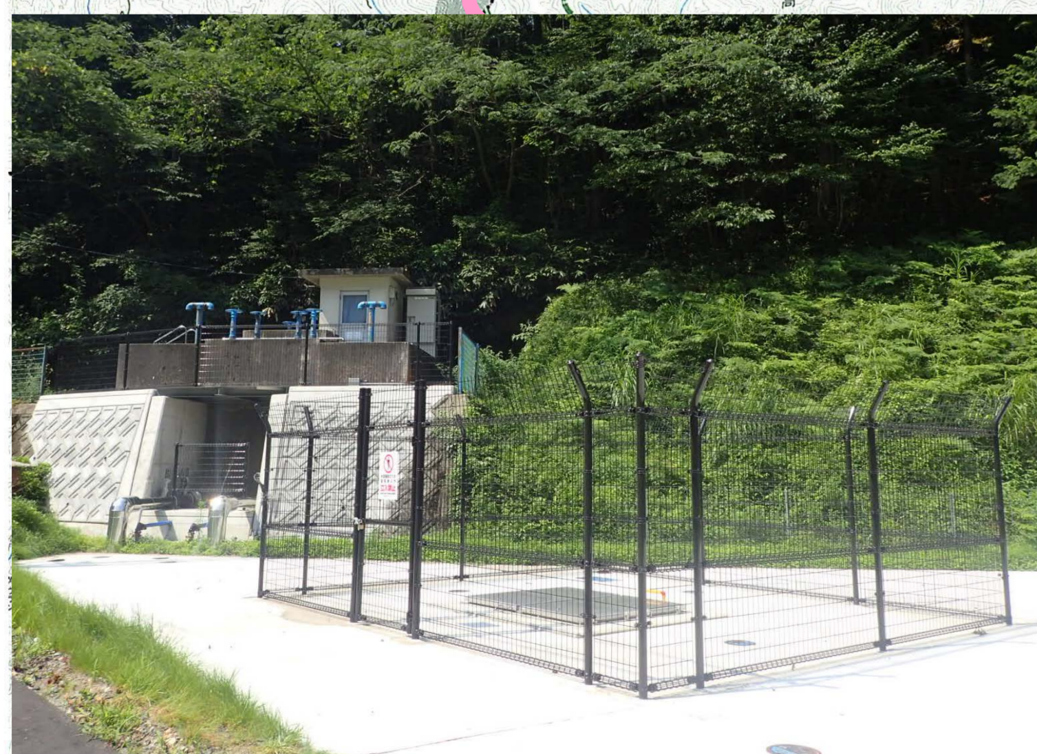
地域⑥ 用瀬町 上安蔵地域：施設整備 （電気計装設備、場内配管）
