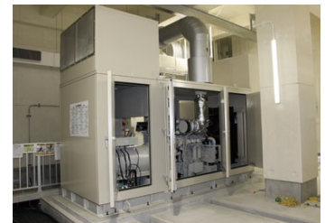
▲叶水源地自家発電機設備 （ディーゼル発電機出力500kVA）
