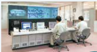
計器による監視
