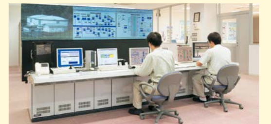
江山浄水場中央監視室
