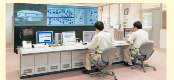
江山浄水場中央監視室
