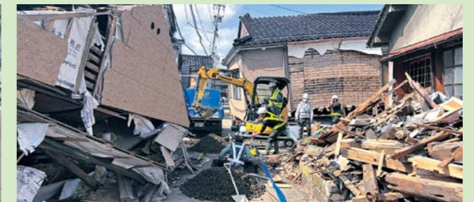
令和6年能登半島地震 (令和6年3月 石川県輪島市)
