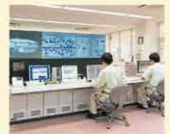
江山浄水場中央監視室
