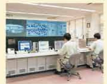
江山浄水場中央監視室
