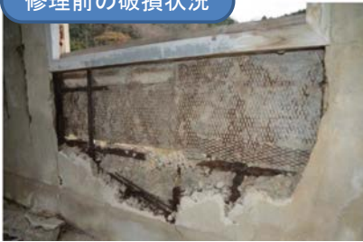
修理前の破損状況
