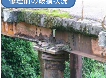
修理前の破損状況
