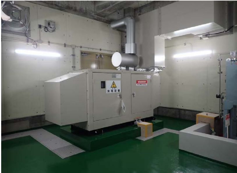
自家用発電機
