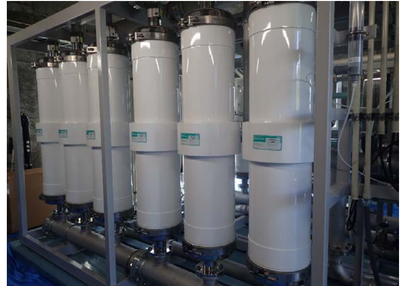
膜ろ過ユニット
