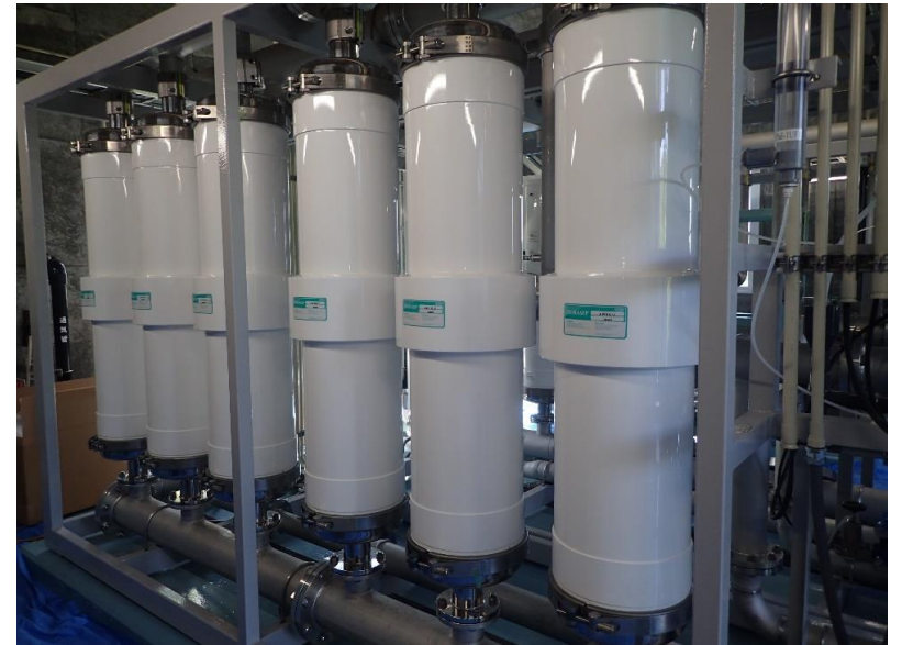
膜ろ過ユニット
