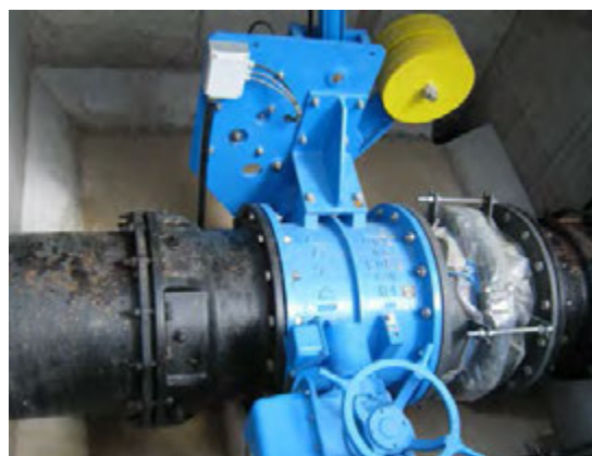
緊急遮断弁（米里配水池）
