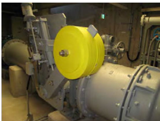
緊急遮断弁（江山浄水場浄水池）
